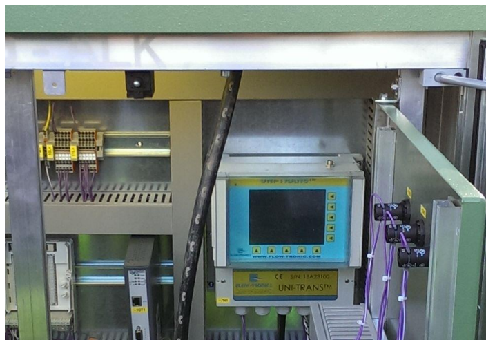
Abb. 3: Messumformer im Schaltschrank
